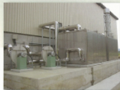
コンポスト脱臭装置
