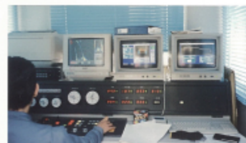
操作制御室内
