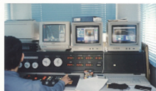
操作制御室内
